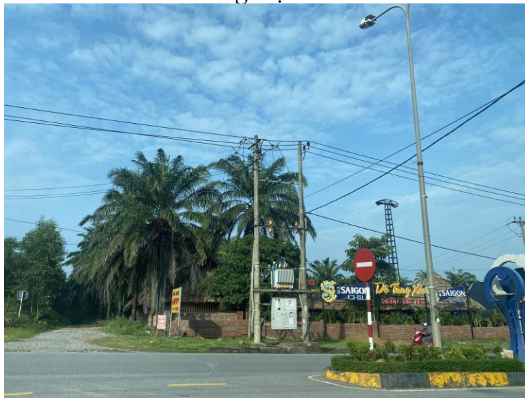
Đường điện 22kV và TBA (22,0,4kV)
