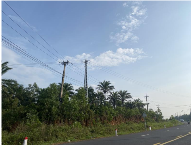
Đường điện 22kV
